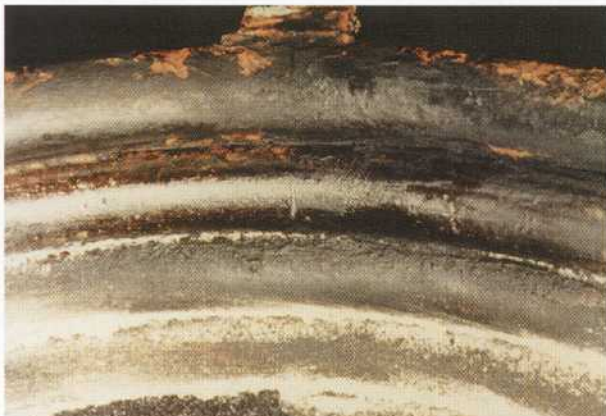
figuur 7.14 Voorbeeld van hoge temperatuurcorrosie
