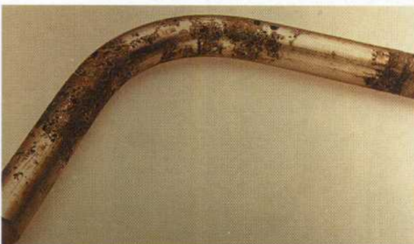
figuur 7.11 Voorbeeld van putvormige aantasting
