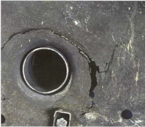
figuur 7.13 Voorbeeld van spanningscorrosie
